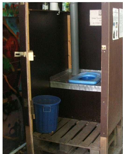
Der Sitz ist in die Außenwände integriert. Hinten links befindet sich das Entlüftungsrohr.
